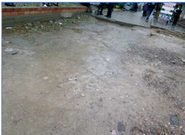
Тротуар, прилегающий к остановке в Чиланзарском районе
